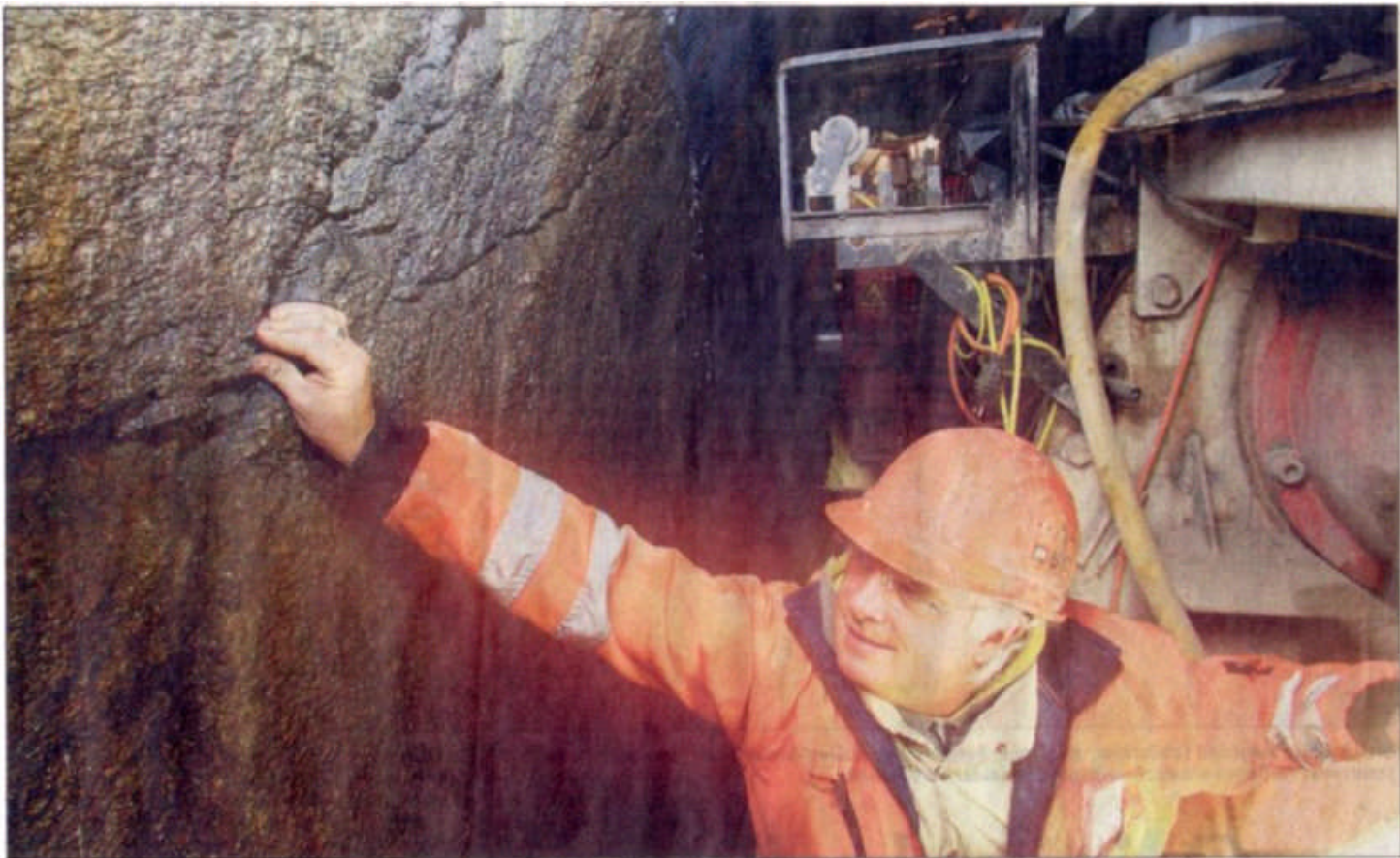
Thomas Beberich von der Bauaufsicht kontrolliert vor Ort die Bedingungen im Gneis. Seit dem Baubeginn vor zwei Monaten hat sich die Vortriebmaschine über 450 Meter tief in den Berg gefräst. Der Stollen wird rund 3,5 Kilometer lang. Durch ihn wird während der Talsperrensanierung das Trinkwasser geleitet und bei einem Hochwasser kann hier künftig ein Teil der Fluten unterirdisch um die Talsperre Klingenberg herum fließen.
